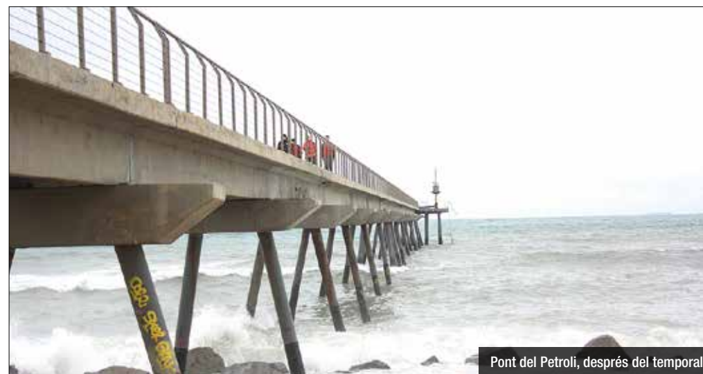
Pont del Petroli, després del temporal
